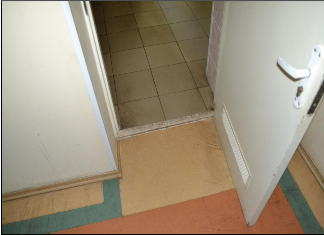
Фото. 1.11. Загальний вигляд перепаду висот підлог, на ділянці влаштованого входу до внутрішнього простору санітарно-гігієнічного приміщення, в рівні першого поверху.
